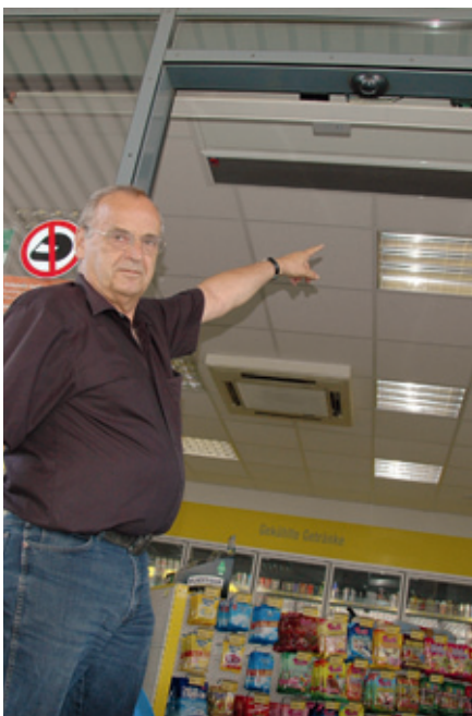
Rainer Moringer, Geschäftsführer von Mighty Dot Austria zeigt, wo die DNA-Dusche montiert wurde.
