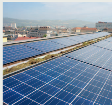
Die Photovoltaikanlage auf dem City Parkhaus.
